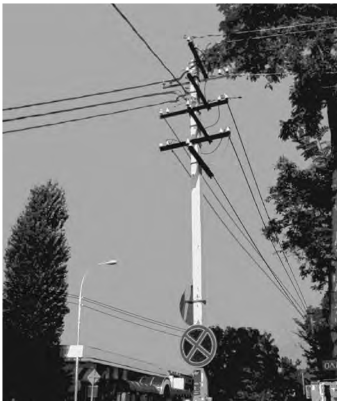
Опора, где пересеклись эпохи и технологии (слева – СИП, справа – неизолированный провод)
